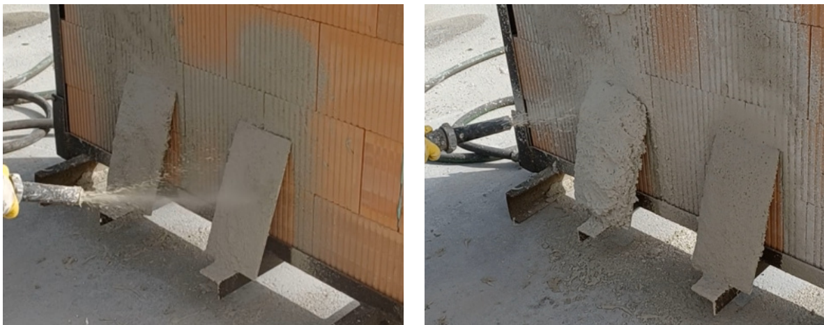
Abbildung 46: Applikation der mineralischen Dämmung mittels Trockenspritzen. Links: Auftrag der Haftbrücke auf die Substrate. Rechts: Auftrag der Dämmschicht mit 50 Gew.-% CSA-Zement und 50 Gew.-% MHGK.
