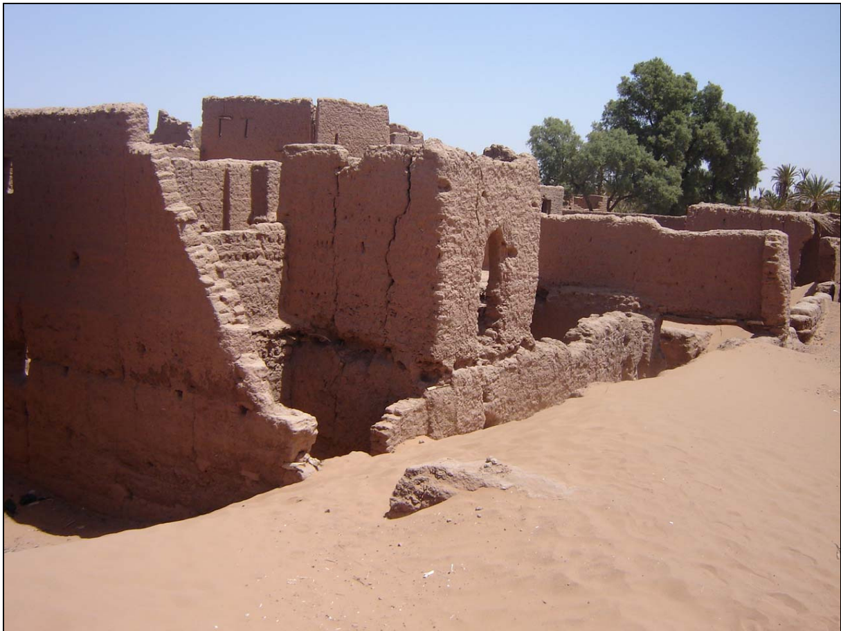
Photo 41 : Ksar Oulad Mhiya effondré et ensablé en grande partie
